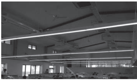
写真-4 オフィス1 LED照明
